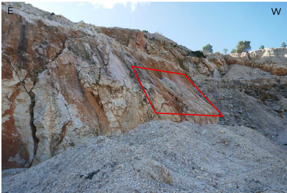
Figure 8: plan associé à F2 à l'origine de l'éboulement récent sur le front 3.
